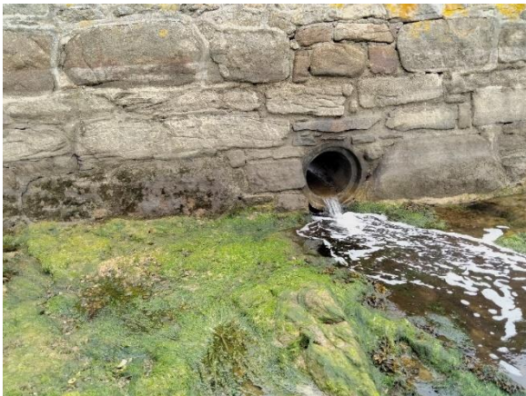
Buse Landrellec aval
